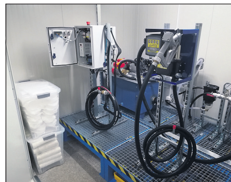
Del notranjosti filtrirne postaje
