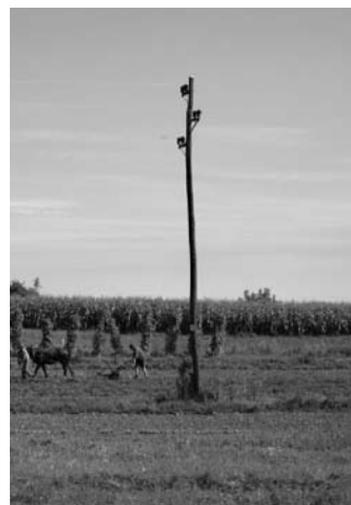
S pločevinasto strešico zaščitena električna drogova sredi polja pod vasjo Orehovec (levo) in na travniku pod vasjo Grič. Foto: Vito Hazler, 18. 8. 2010
