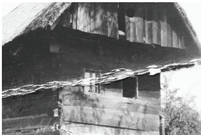
Zaradi prepogibanja fotografije je poškodovana emulzijska plast. Foto Miha Špiček
